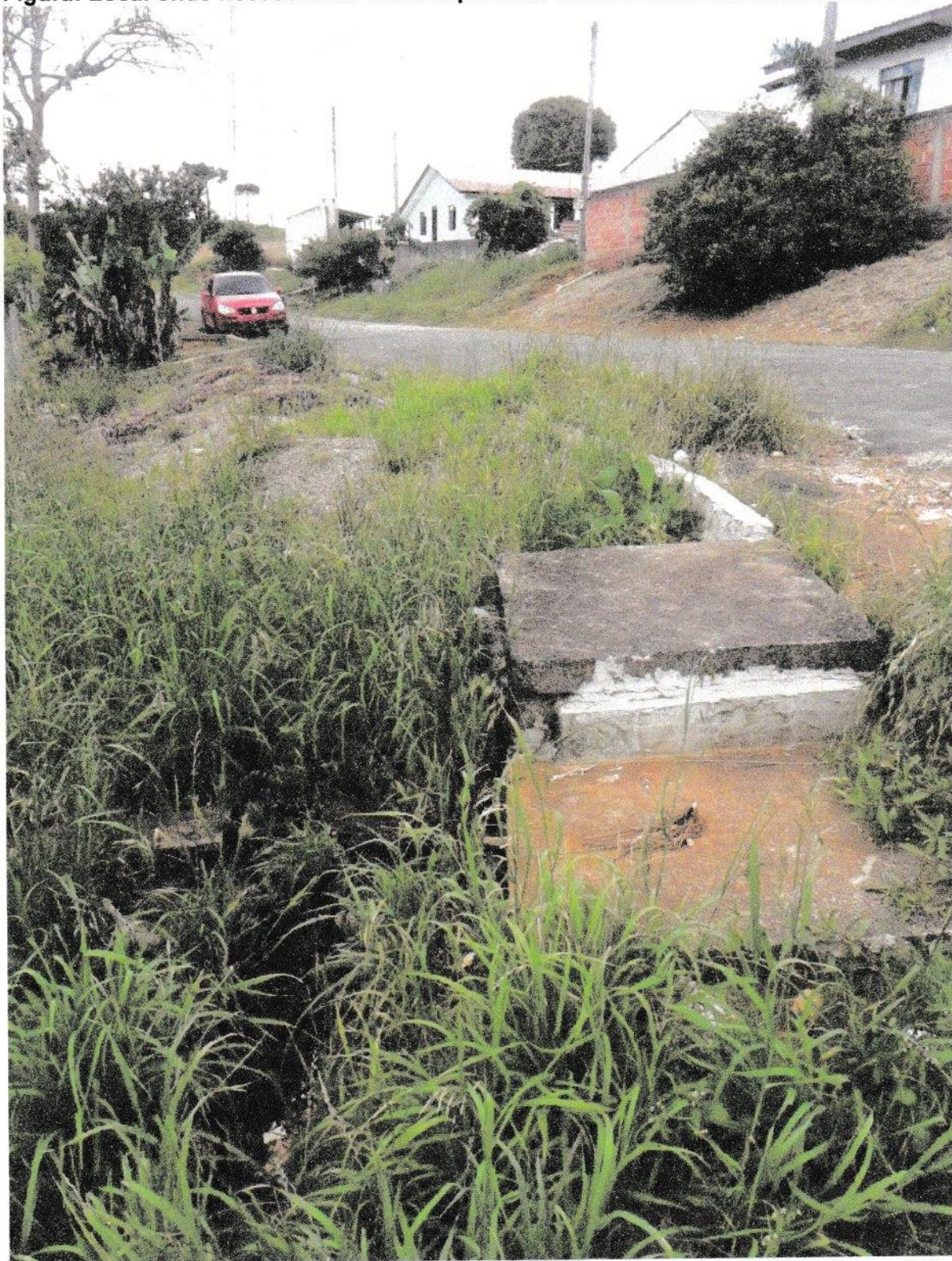
Figura: Local onde necessita do desentupimento do manilhamento na Rua Eufrates.
